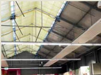
Hier schön zu sehen: die Flächenstrahler der Infrarotheizung, der Schattenschirm und die Festeindeckung auf der Südseite.
